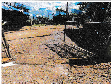
Foto 3: Portón de la escuela con óxido por el agua que se entra al patio.
