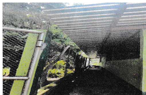
Foto 6: Caidas de agua a un costado de la escuela, causan pozas de agua en este patio trasero.
