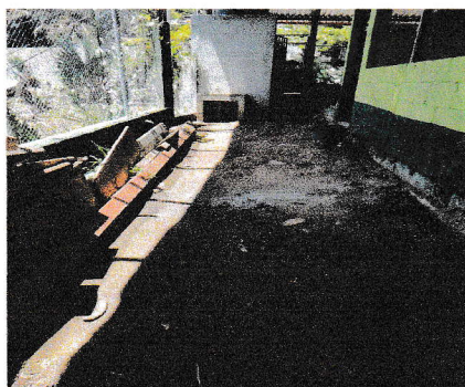
Foto 3: Patio trasero de la escuela. Se llena de agua pluvial.
